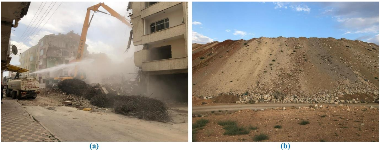
Şekil 3. Sivrice-Elazığ depreminde (a) Yıkım sonrası ortaya çıkan inşaat ve yıkıntı atığı, (b) Kontrolsüz depolama sonrası ortaya çıkan atık tepecikleri.
