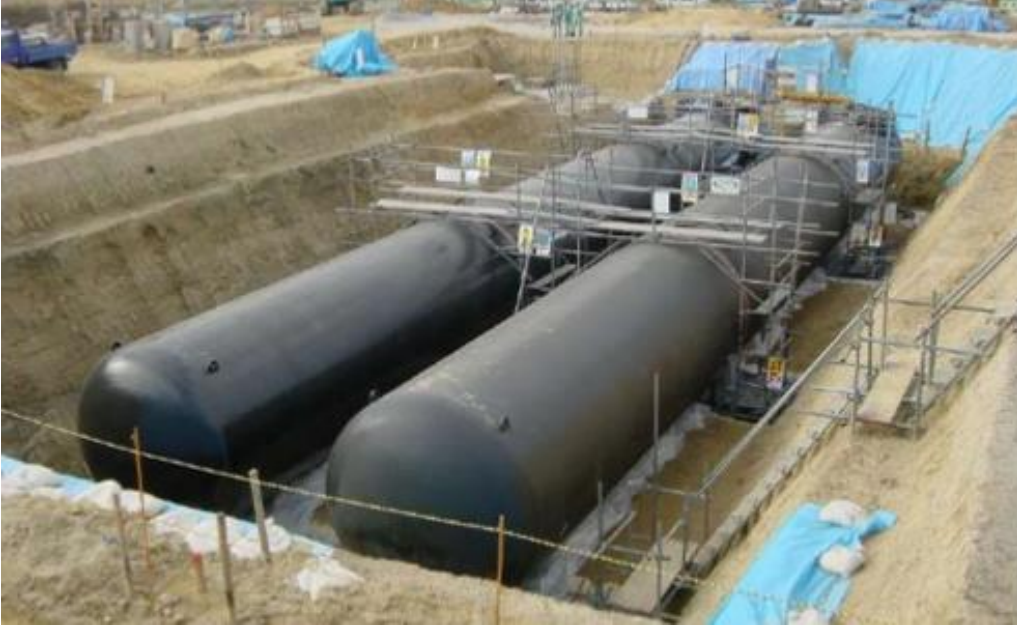
Şekil 12 .Geçici iskan alanları veya toplanma bölgeleri için su tankları
